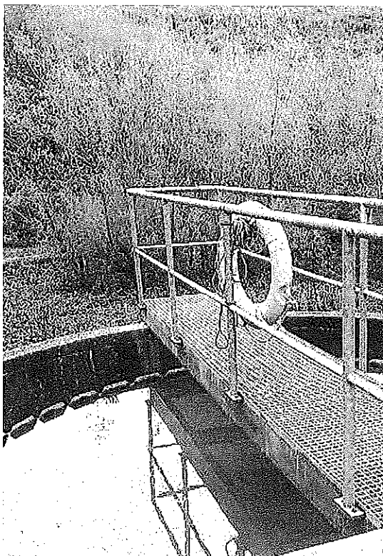
Depuradora de aguas ubicada en la localidad de Maeztu. Foto: DNA
