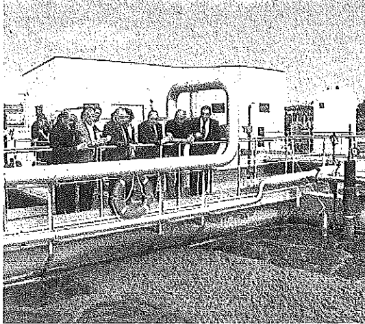
Las autoridades comprobaron el funcionamiento de la depuradora.
