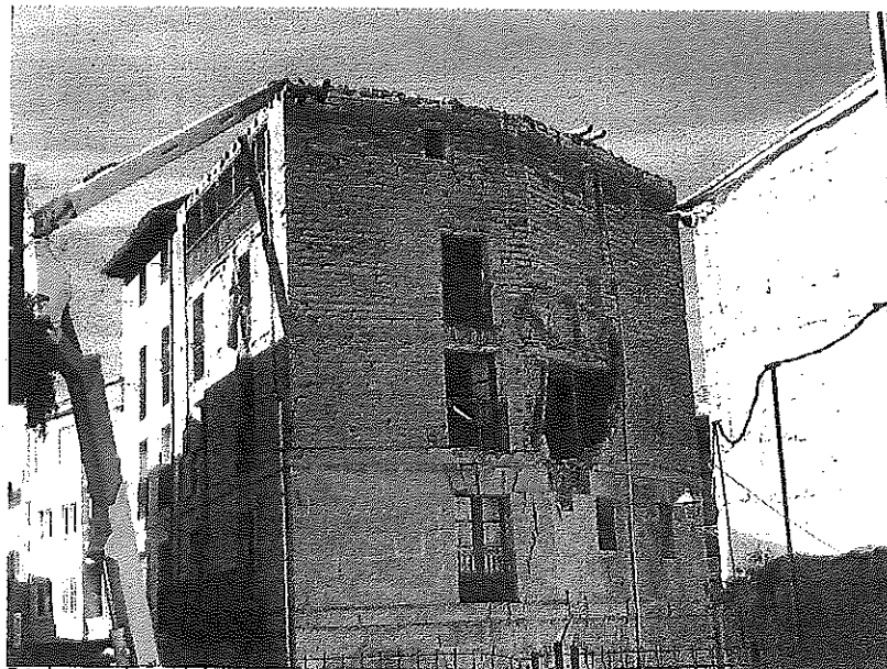
Estado en que ha quedado la fachada del edificio sito en Linares Rivas 13 tras el desplome de ayer. ó.s.j.
