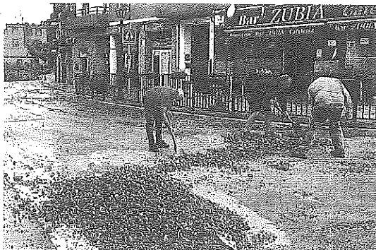
Algunas calles de Lapuebla sufrieron daños por arrastre de tierra. e. c.
