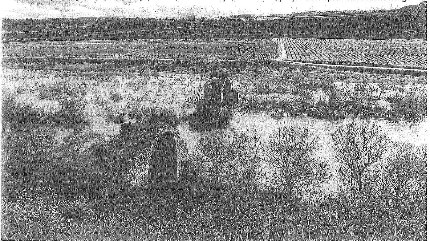
Imagen de los restos de la construcción antes del último colapso de la estructura en la parte logroñesa del río Ebro.
