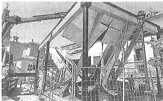
La estructura que se desplomó por el peso en Oyón. AYUNTAMIENTO OYÓN
